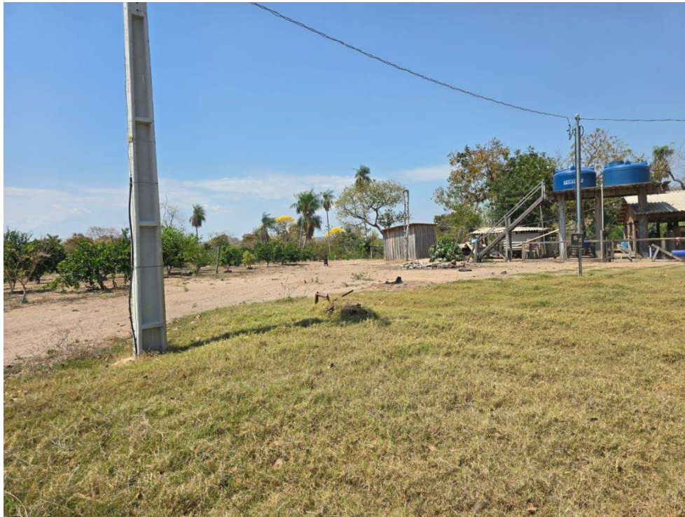
Figura 11 – Rede elétrica rural
